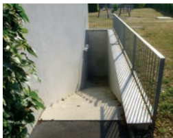
Fehlende Handläufe und Position der Absturz- sicherung
