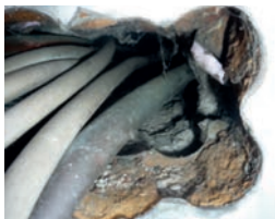
Keine fachgerechte E-Installation-Brandab- schnitt durchbrochen
